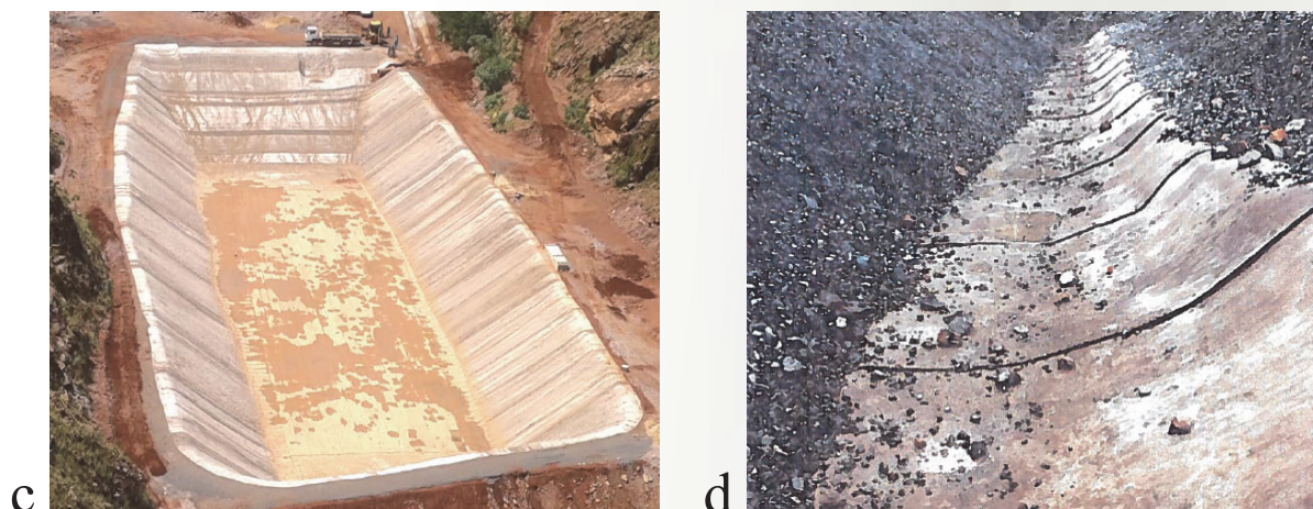
Рис. 14. Применение бетонного полотна в горнодобывающей промышленности: а — вентиляционные перемычки; б — промышленные полы; в — противодиффузионные сооружения; д — нагорные каналы
